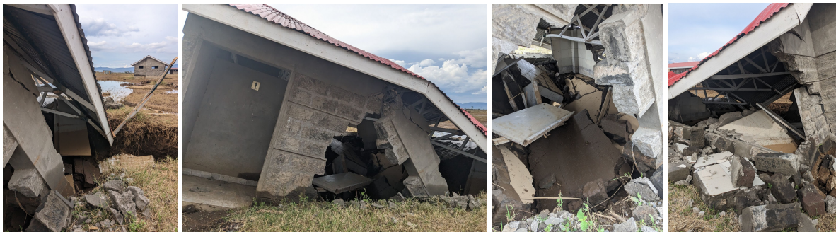
Das eingestürzte Toilettenhäuschen
